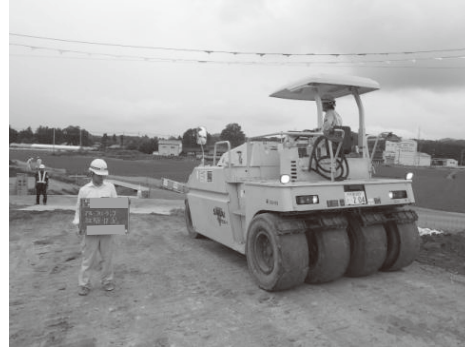
変形（沈下量）の確認
