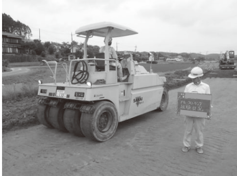
変形（沈下量）の確認
