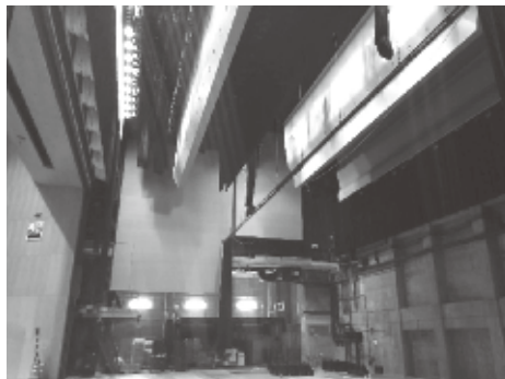
更新された大ホールの吊物機構
