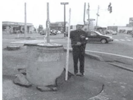
マンホールの突出 (平成16年 新潟県中越地震)
