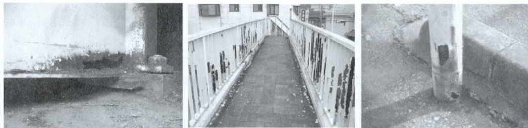
橋りょう (主桁の腐食)
