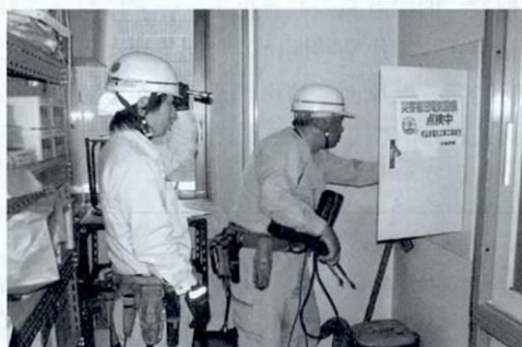
分電盤を確認している組合員
